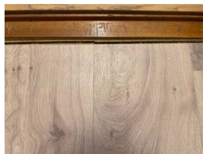
Det mangler overgangslist mellom laminat - ytterdør.
