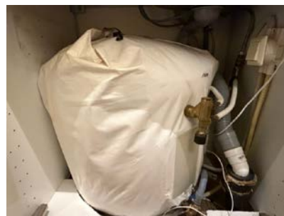
Varmtvannstank i kjøkkenskap.
