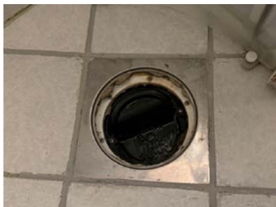
Plastsluk i dusjsone.
