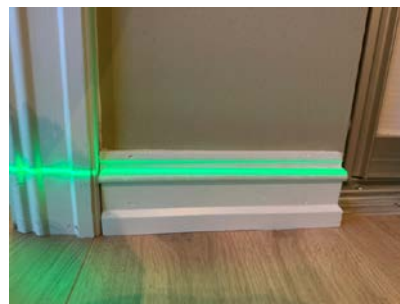
Bilder viser skjevheter i gulv i stue.
