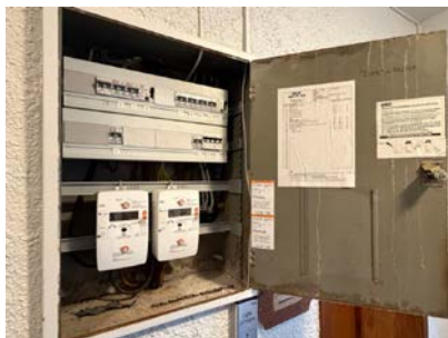
Sikringsskap i fellesarealer.
