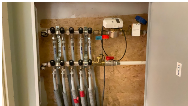
Rørskap i bod.
