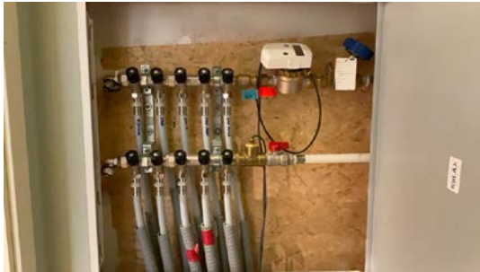
Rørskap i bod.
