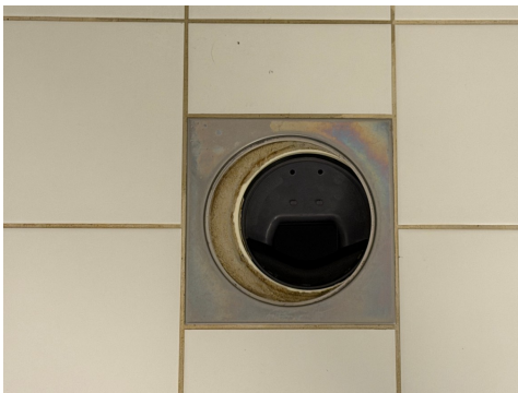
Plastsluk i dusjsone.
