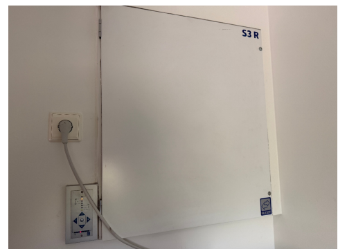
Luftbehandlingsaggregat på vaskerom.
