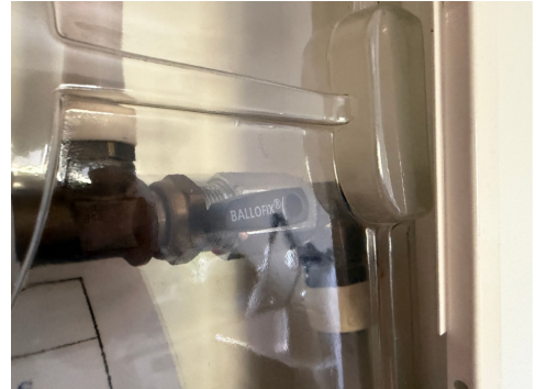
Stoppekran i rør i rør skap.
