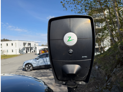
El. bil ladestasjon v/ biloppstillingsplass
