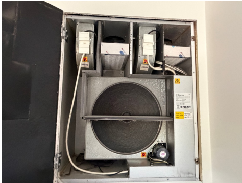
Luftbehandlingsaggregat bak deksel.
