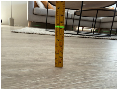
Bilder viser skjevheter i gulv i stue/kjøkken.
