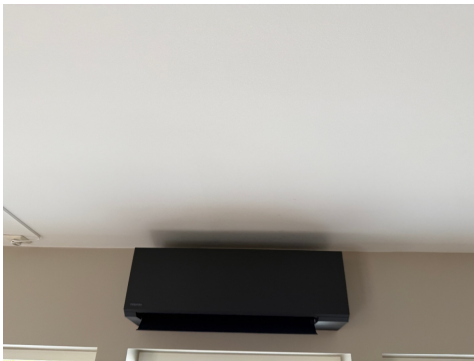
Varmepumpe med uttak i stue/kjøkken.
