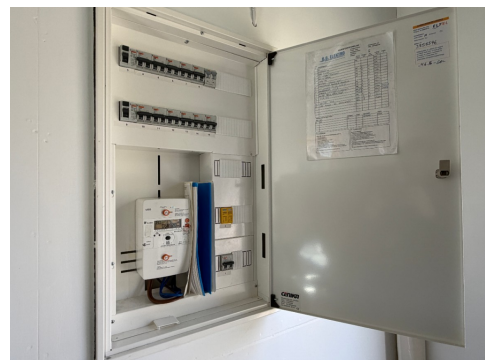
Sikringssskap i bod.
