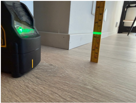
Bilder viser skjevheter i gulv i stue/kjøkken.
