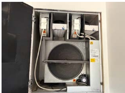
Luftbehandlingsaggregat bak deksel.
