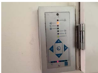
Bryterpanel v/ aggregat. Bør stå på maks effekt v/ dusjing.
