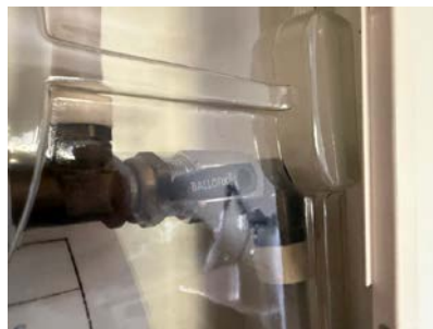
Stoppekran i rør i rør skap.
