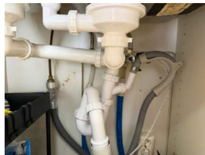
Rørøpplagg under vask.
