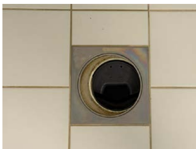
Plastsluk i dusjsone.
