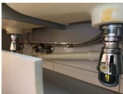
Rørøpplagg under servant.
