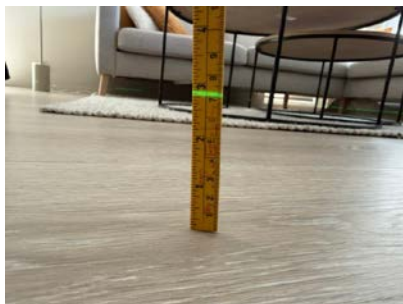
Bilder viser skjevheter i gulv i stue/kjøkken.
