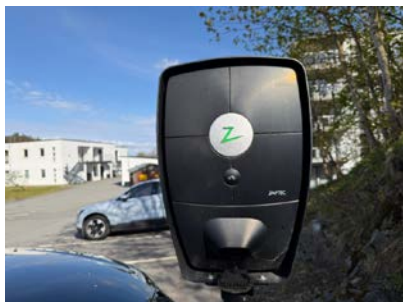
El. bil ladestasjon v/ biloppstillingsplass
