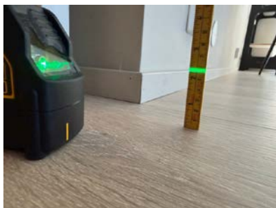
Bilder viser skjevheter i gulv i stue/kjøkken.
