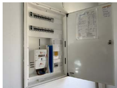
Sikringsskap i bod.
