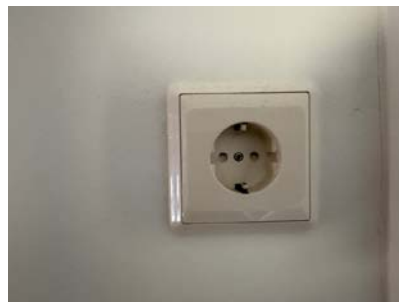
Ingen tegn til varmgang i stikkontakt til varmtvannstank. Stikkontakt bør allikevel skiftes til fast el. tilkobling for å unngå varmgang og brannfare.
